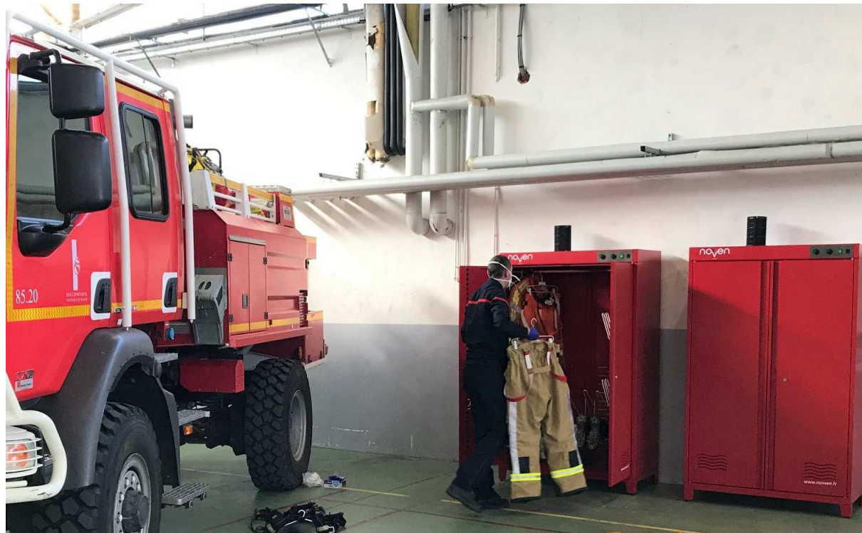
En fonction de l'organisation de l'infrastructure, les armoires séchantes peuvent être disposées dans les remises. © Anthony Bessonier- SDIS 85
